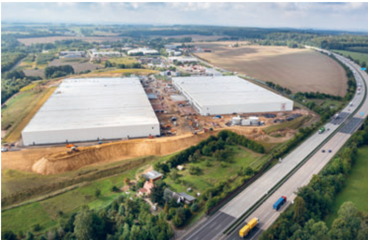
Ende Oktober ist die Fertigstellung des Logistikzentrums Mittelsachsen auf der Zielgeraden angekommen
